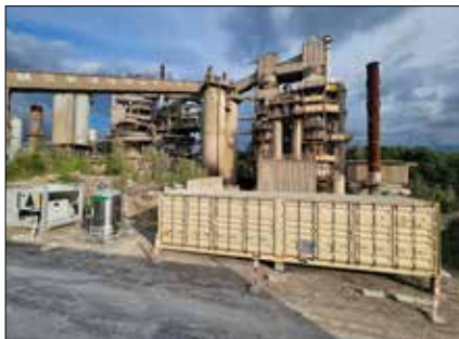
Fig. 2 – Anti-sublimatie cryogene CO 2 -afvang pilotinstallatie (test voor kalkproductie)
